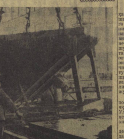
КОБУЛ, Совет Иттифоқининг ёрдами билан тикланган уй-жой қурилиши комбинатда янги бинолар учун блок-деворларни прессалайти. В. Соболев фотоси, (ТАСС).
