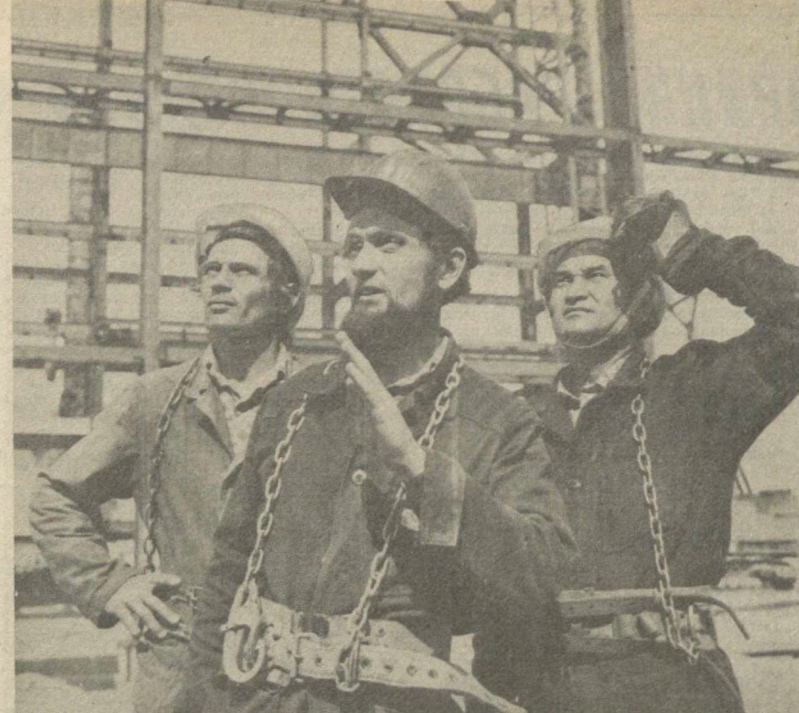
К монтажу главного корпуса приступили на Мубарекской ТЭЦ. На этой стройке уже освоено семь с половиной миллионов рублей. Коллектив строителей и монтажников обязался досрочно сдать в нынешнем году первую очередь возводимого объекта — турбоагрегат и котел. На снимке: члены передовой бригады монтажников В. Хаменок, Л. Нарусь (бригадир) и Б. Вегиев. Фото Ш. ШАРАПОВА (УзТАГ).
