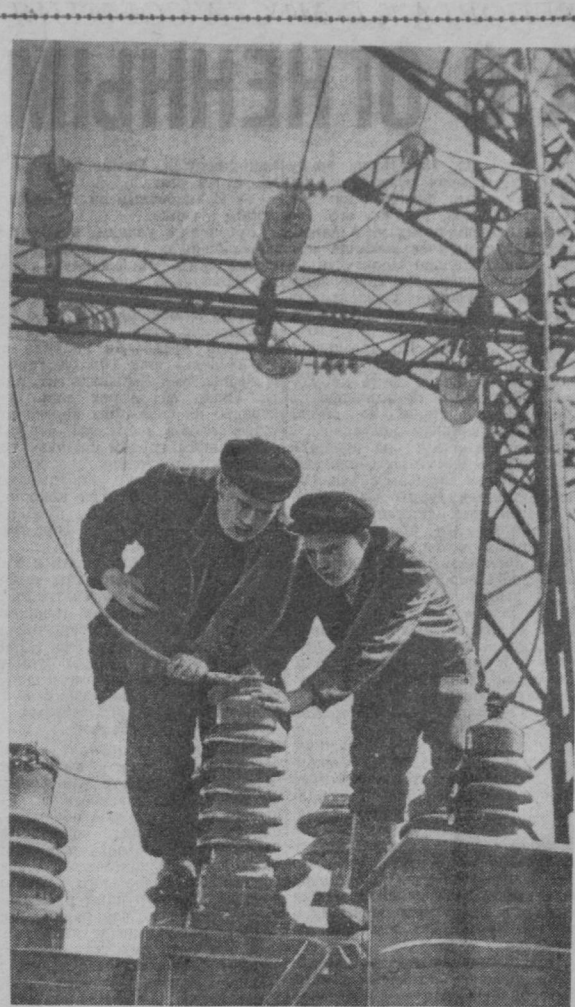
Сдана в эксплуатацию подстанция «Нукус». Ее ток получили многие хозяйства Кеейлинского производственного управления. Скоро начнут работать второй трансформатор мощностью 10 тысяч киловатт. Он снабдит электроэнергией Нукусский телецентр и отдаленные совхозы «Каразак» и «Таштактир» Чимбайского управления. На снимке: электроинженеры-ремонтники Эргаш Нуржанов и Арабай Турсынбаев на монтаже подстанции.
