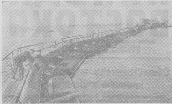
В Казани начато строительство нового речного порта, предусмотренное в директивах XIX съезда партии по пятилетнему плану. Это будет один из крупнейших и механизированных портов на Волге.
