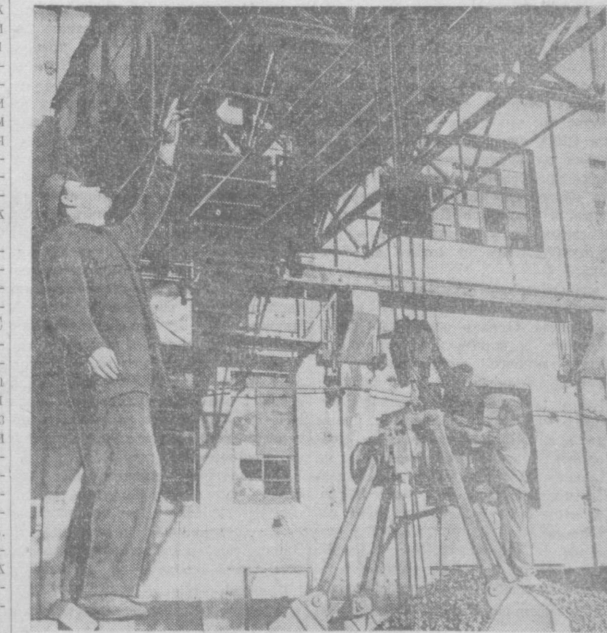
По инициативе общезаводского постоянно действующего производственного совещания на шихтовом дворе литейного цеха завода «Ташсельмаш» заканчивается монтаж магнитореферного подъемного крана.
