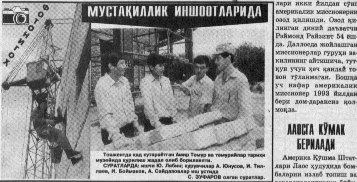
Тошкентда қад қутараётган Амир Темуэр ва темурийлар тарихи музейида қурилиш жадал олиб борилаёпти. СУРАТЛАРДА: ишчи Ю. Либин; қурувчилар А. Юнусов, И. Тўлаев, И. Боймаков, А. Сайдаволов иш устида. С. ЗУФАРОВ олган суратлар.
