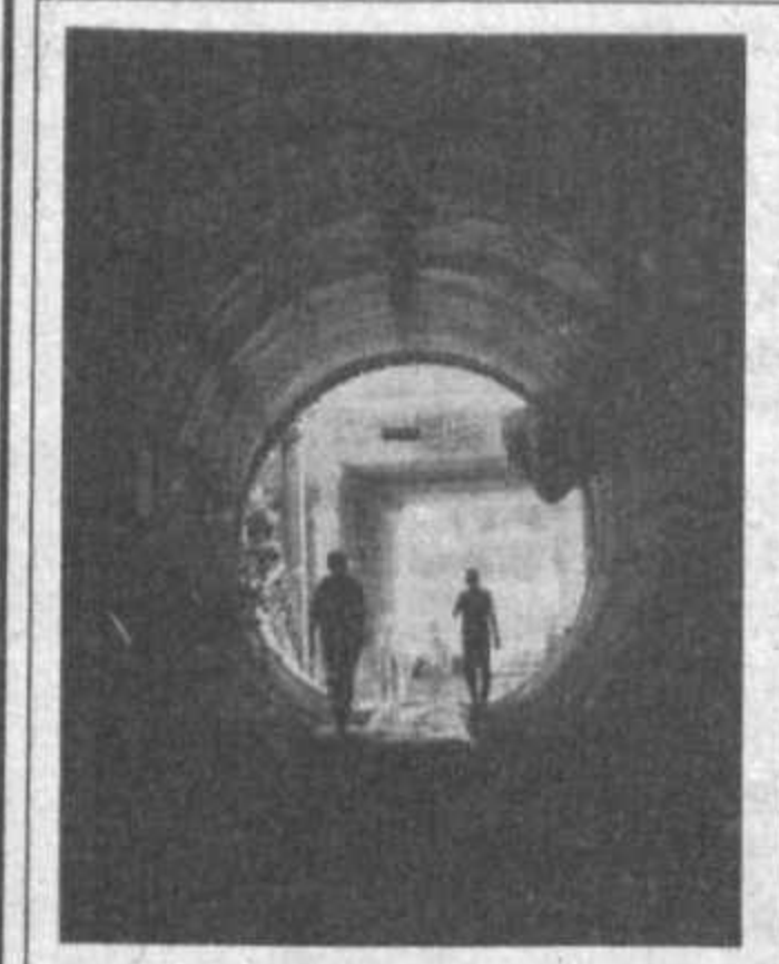
Третью часть пути прошли проходчики тоннельного отряда №2 "Ташметрострой" от станции "Абдулла Кадыри" до станции "Минор" строящейся Юнусабадской линии метрополитена.
