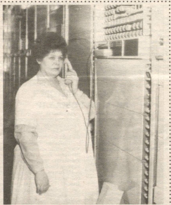
Тошкент шаҳарлараро телеграф-телефон станцияси халқаро коммутация цехининг буюртма орқали улаш мажмуаси раҳбари Л. БЕЛИЕВА навбатдаги мижоз талабини бажармоқда. Т. ЛУТФУЛЛАЕВ олган сурат
