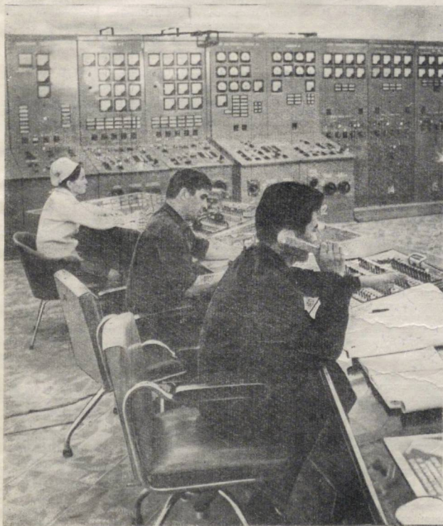
Совет фани қудрати тухайли мамлакатимиз йил сайин чарогонлашмоқда. Суратларда: Тахиятош ГРЭСининг бошқарув пулти. Унга: Чирчиқ шаҳрининг элктр томирлари.
