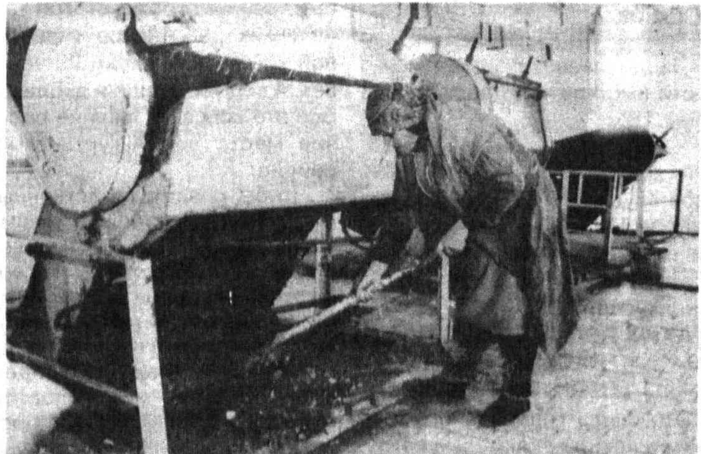
На снимках: Алиджон Жагбаров: «Вот эти трубы должны были подавать до 55 тысяч кубов стоков в сутки на мехочистку. Начальство решило обойтись...»
