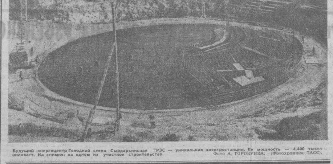
Будущий энергозастой Голодной степи Сырдарьинской ГРЭС — уникальная электростанция. Ее мощность — 4.400 тысяч киловатт. На снимке: на одном из участков строительства.
