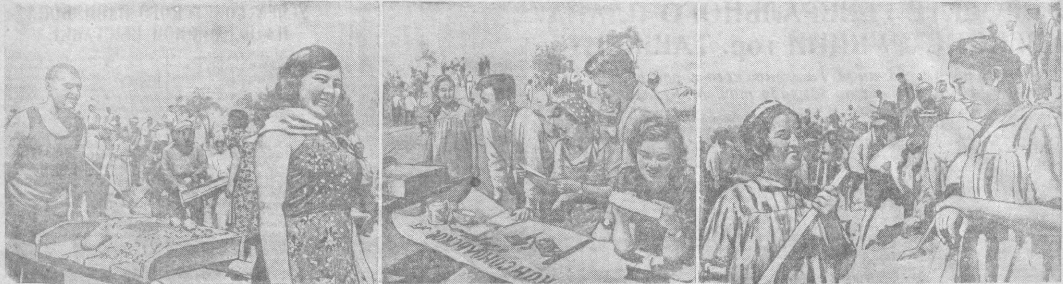
По инициативе комсомольцев в Ташкенте сооружается опрочное искусственное озеро, которое будет прекрасным местом отдыха для трудящихся города. На стройке озера кипит горячая работа. На снимках: Слева — комсомольцы — студенты Педагогического института тт. В. Бахметьев и Т. Милова выносят грунт из котлована. В центре — выпуск стенной газеты «Комсомольское озеро». Справа — студентки тт. Сарбахан Бабаева и Мастура Якубова. Фото М. Пенсона.
