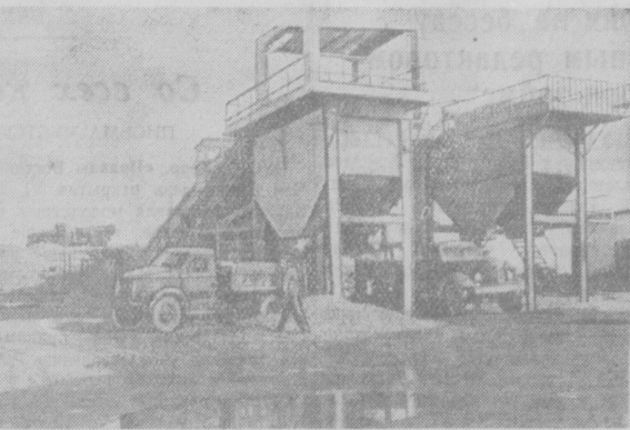
Ташкентская область. На Кульлюкском карьере георазработок Министрства промышленности строительных материалов Узбекской ССР сдана в эксплуатацию вторая дробильно-сортировочная установка. Сотни кубометров песка, гравия и щебня ежедневно отгружаются для возведения промышленных и жилых объектов Ташкентской области. Включившись в соревнование в честь 40-й годовщины Великого Октября, коллектив карьера решил перейти на трехсменный график работы и досрочно выполнить годовую план. На снимке: новая дробильно-сортировочная установка. Фото Г. Пуна. (Фотокроника УзТАГ).
