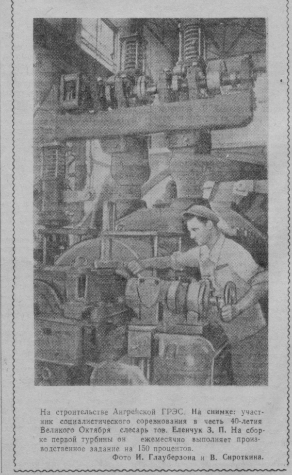
На строительстве Ангреевской ГРЭС. На снимке: участки социалистического соревнования в честь 40-летия Великого Октября слесарь тов. Еленчук З. П. На сборке первой турбины он ежемесячно выполняет производственное задание на 150 процентов. Фото И. Глауберзона и В. Сироткина.
