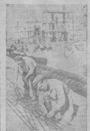
Белорусская ССР. Коллектив строителей Василиевской ГРЭС значительно перевыполнил полугодовой производственный план. Первенство в соревновании держат строители гидроузла. На снимке: лучшие монтажники гидроузла Василий Кахино (справа) и Василий Нестеров за подготовкой арматуры для гидросооружений. Они выполняли за смену 170—180 процентов нормы. Фото Ф. Романова. (Фотохроника ТАСС).
