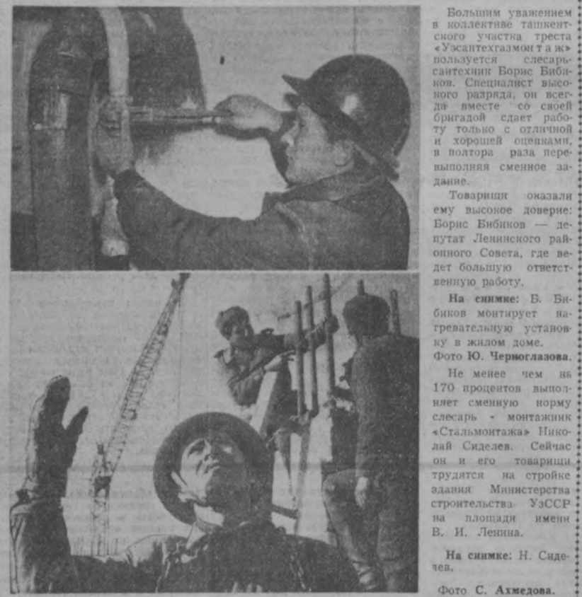
На снимке: В. Бибинов монтирует нагревательную установку в жилом доме. Фото Ю. Черноглазова.
