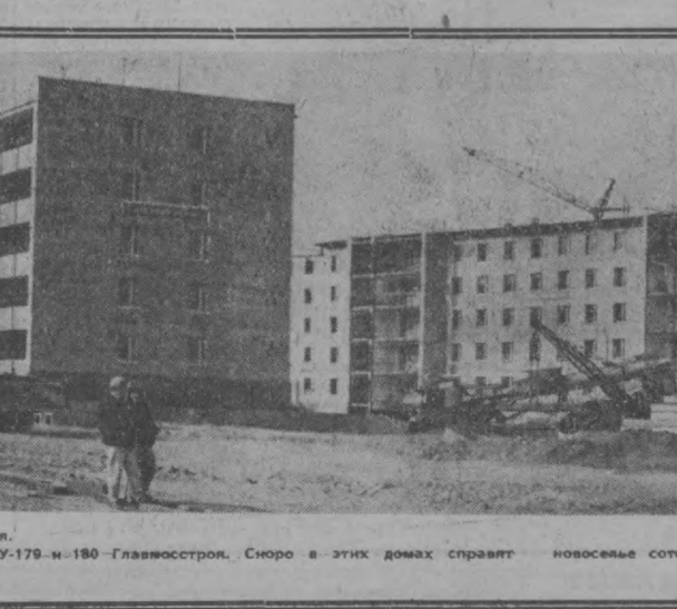
Сегодня в квартале Главмострой. На снимке: новые жилые дома СУ-179 и 180 Главмострой. Скоро в этих домах спрячут новоселье сотни ташкентских семей. Фото М. Нуритдинова.
