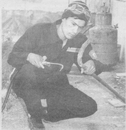
У тех, кто трудится в Шайхантаурском районном отделении предприятия «Ташгаз», в холодную пору года объем работы возрастает, но опыт и мастерство помогают решать задачи быстро и оперативно.
