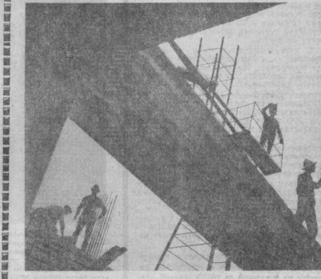
ТАШКЕНТ. На улице Навои строится пятиэтажное здание главного универмага на 400 торговых мест. На его кровле расположится кафе «Чор-су». Воздвигают универмаг строители треста № 11 Высокострой. Они обещают сдать его в эксплуатацию к концу пятилетия.
