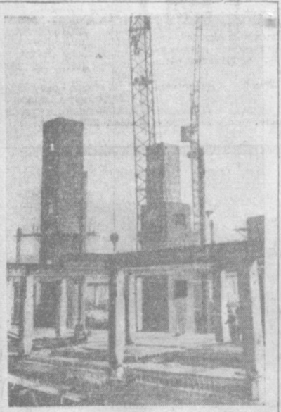
Усиленными темпами ведется строительство здания музея В. И. Ленина. Сдать объект в эксплуатацию и 100-летие со дня рождения вождя — почетная и ответственная задача строителей. НА СНИМКЕ: один из участков строительства музея В. И. Ленина. Фото М. Нуритдинова.
