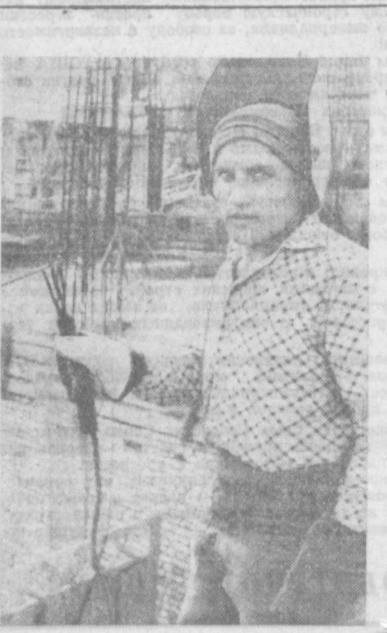
По-ударному трудится на строительстве Музея искусств электротехники Фарид Бекметов из СУ-33 треста № 6. НА СНИМКЕ: Фарид Бекметов. Фото Р. Абдурахманова.
