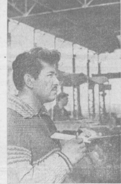
«Ташсельмаш» сейчас переживает свое третье рождение. Сносятся старые тесные здания, на их месте вырастают современные корпуса новых цехов. НА СНИМКЕ: инженер отдела капитального строительства завода П. Хашимов на строительной площадке нового цеха. Фото В. Ломовцева.
