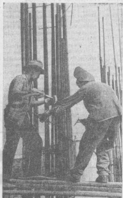
Строительным Управлением «Ташкентстрой» на Высочовольном массиве возводятся девятиэтажные дома. В одном из них на первом этаже разместится бытовая столовая. НА СНИМКАХ: передовые строители. Вверху — электросварщик Степан Копылев и бригадир Владимир Михайлович Винау — сварщик Рахим Шафигулов и Ишмурат Диаллоев. Фото М. Нуритдинова.
