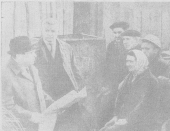
Решения сессии Верховного Совета республики горячо восприняты ташкентскими метрополитенцами прежде всего потому, что там предусмотрены средства для строительства метрополитена в столице Узбекистана. В обеденный перерыв к рабочим, пока что сооружающим коллектор ГУМА, приехали познакомиться с документами сессии начальник тоннельного отряда № 2 П. В. Канцис (слева) и секретарь партбюро В. А. Гомизлов. Фото члена нашего контрольного поста В. Митрофанова.
