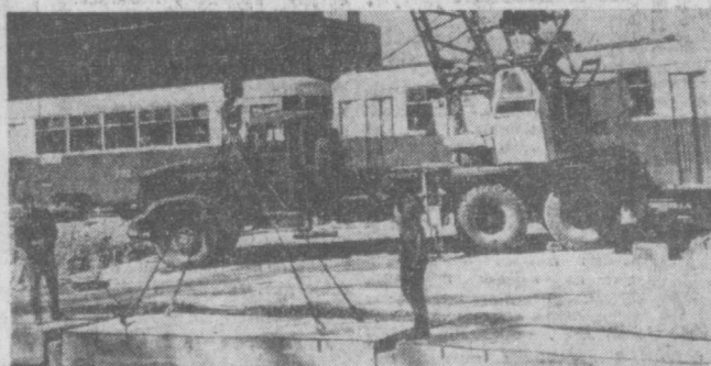
На проспекте Ленина полным ходом идут работы. На снимках нашего фотокорреспондента М. Нуритдинова запечатлены будни дорожников (слева) и строителей, сооружающих подземный переход.
