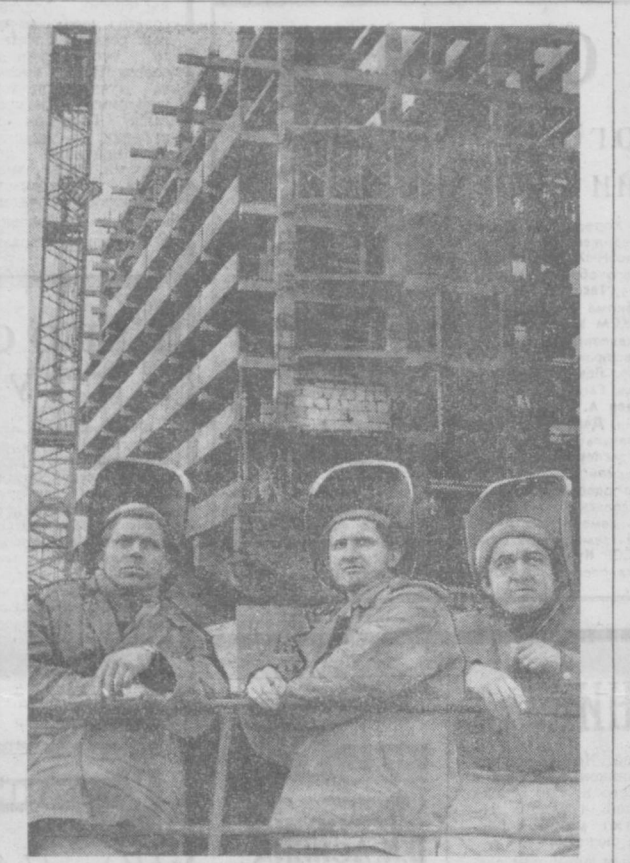
Сварщики-монтажники Т. Абдураманов, А. Бабин и В. Айдашев (су-2, трест «Высстрой-1») работают на строительстве Дома молодежи. Все они ежедневно перевыполняют задания. Фото Ю. Бутусова.
