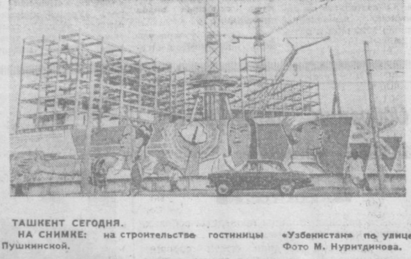
ТАШКЕНТ СЕГОДНЯ. НА СНИМКЕ: на строительстве гостиницы «Узбекистан» по улице Пушкинской. Фото М. Нуритдинова.
