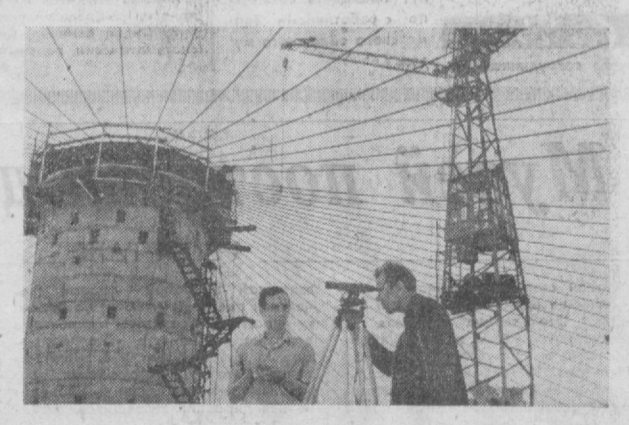
КИЕВ. В Дарницком районе столицы Украины строится экспериментальный автобусный парк. Его основной корпус будет напоминать большое цирковое здание, на «арене» которого размещается около 400 автобусов. В нем не будет привычных колонн, вместо них сооружена одна центральная опора со стальными тросами. Центральная опора, построенная в виде башни, служит одновременно и вентиляционной камерой. НА СНИМКЕ: на строительстве автобусного парка. Фото А. Поддубного.
