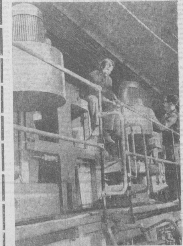
В одном из корпусов издательства ЦК КП Узбекистана идут наладочные работы и монтаж оборудования комплекса глубокой печати. НА СНИМКЕ: монтажники за работой. Фото М. Нуритдинова.
