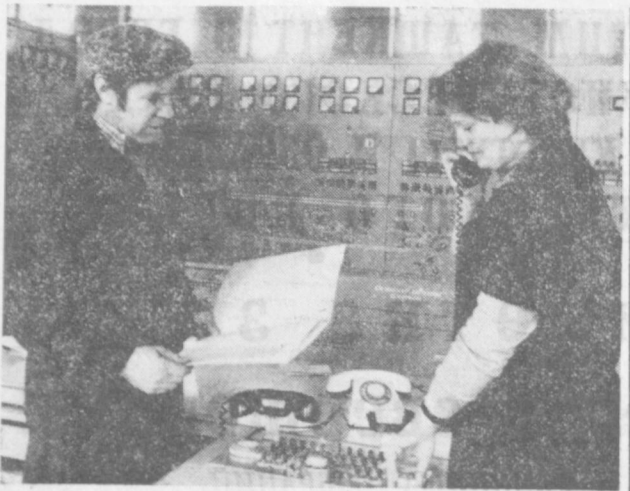
Почти тридцать лет трудится в бригаде слесарей по ремонту электротехники Евгений Петрович Пенков в центральной ремонтной бригаде службы подстанции Ташкентского предприятия электросети. Он прекрасно владеет специальными инструментами: электросварочником, слесаря, токаря. Ветеран предприятия воспитал не один десяток специалистов высших разрядов. Среди них — В. Ангилнов, В. Перцов, Р. Алимбаев и другие. Многие воспитанники, как, например, электрослесарь 6-го разряда Т. Исханов, продолжают работать в бригаде своего наставника. НА СНИМКЕ: Е. П. Пенков и дежурный инженер В. В. Костынина.
