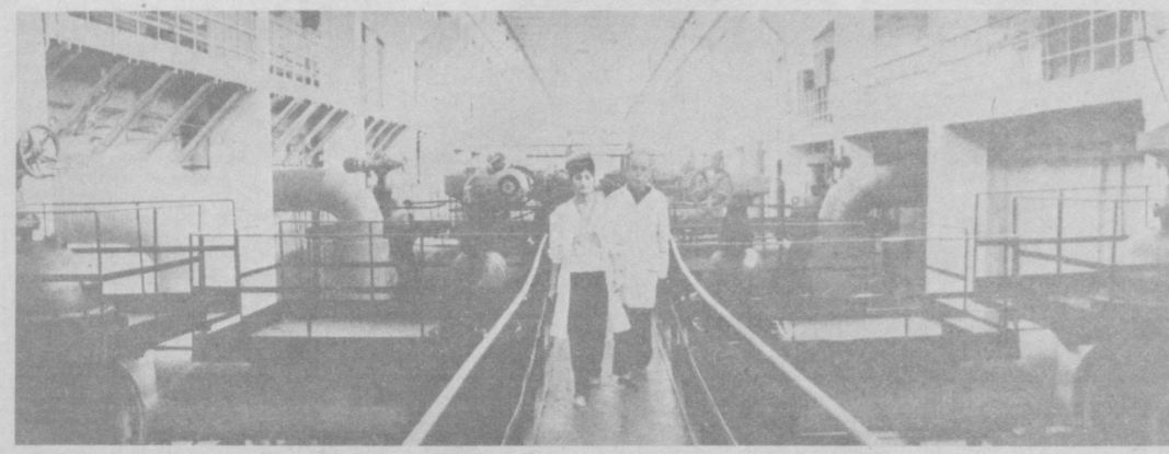
Не один год в цехе очистки на головных сооружениях кадрынского водопровода работают инженер Абдували Абдувалиев и оператор IV разряда Феликс Куртсоев. Благодарим их усилия, а также труду сотен работников других подразделений треста «Водоканал» горожане бесперебойно снабжаются питьевой водой.
