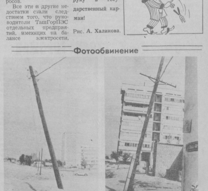
Давно покосились столбовые опоры для электропроводов по улице Бегагач и рядом со школой № 23 в Октябрьском районе. Фото М. Нурдинова.
