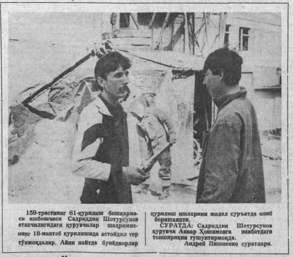
150-трестнинг 61-қурилиш бошқармаси ишбoшчиси Садриддин Шотурсунов етакчилигидаги қурувчилар шахримизнинг 18-мактаб қурилишида астойдил тер тўқмоқлар. Айна пайтда буёндорлар қурилиш ишларини жадал суръатда олиб боришапти.
