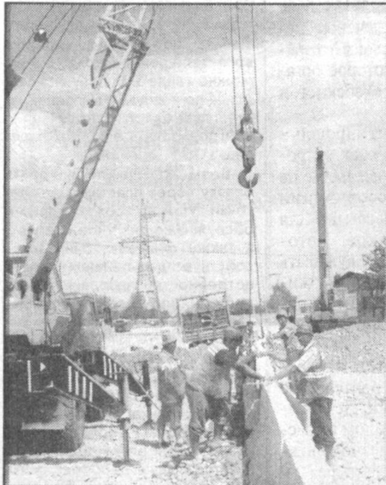
ВЫСОКИМИ ТЕМПАМИ ИДЕТ СТРОИТЕЛЬСТВО КОЛЬЦЕВОЙ ДОРОГИ НА УЧАСТКЕ КУЙЛЮК-ИППОДРОМ ПРОТЯЖЕННОСТЬЮ ШЕСТЬ КИЛОМЕТРОВ. РАБОТЫ ВЕДЕТ КОЛЛЕКТИВ ДОРОЖНО-СТРОИТЕЛЬНОГО ОБЪЕДИНЕНИЯ «АВТОМАГИСТРАЛЬ».
