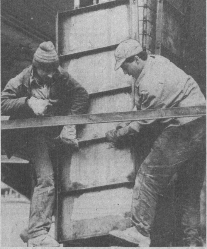
В августе прошлого года была возобновлена реконструкция концертного зала имени Я. М. Свердлова в Ташкенте. Работы осуществляет комплексная бригада АТМК-7 треста «Ташнефтедстрой», а также проектно-технологическое конструкторское бюро Министерства культуры Республики Узбекистан. Постановление правительства на строительство объекта выделено 10 миллионов рублей. Координацию работы всех служб обеспечивает штаб под председательством заместителя хокима Ташкента Б. К. Алиева.
