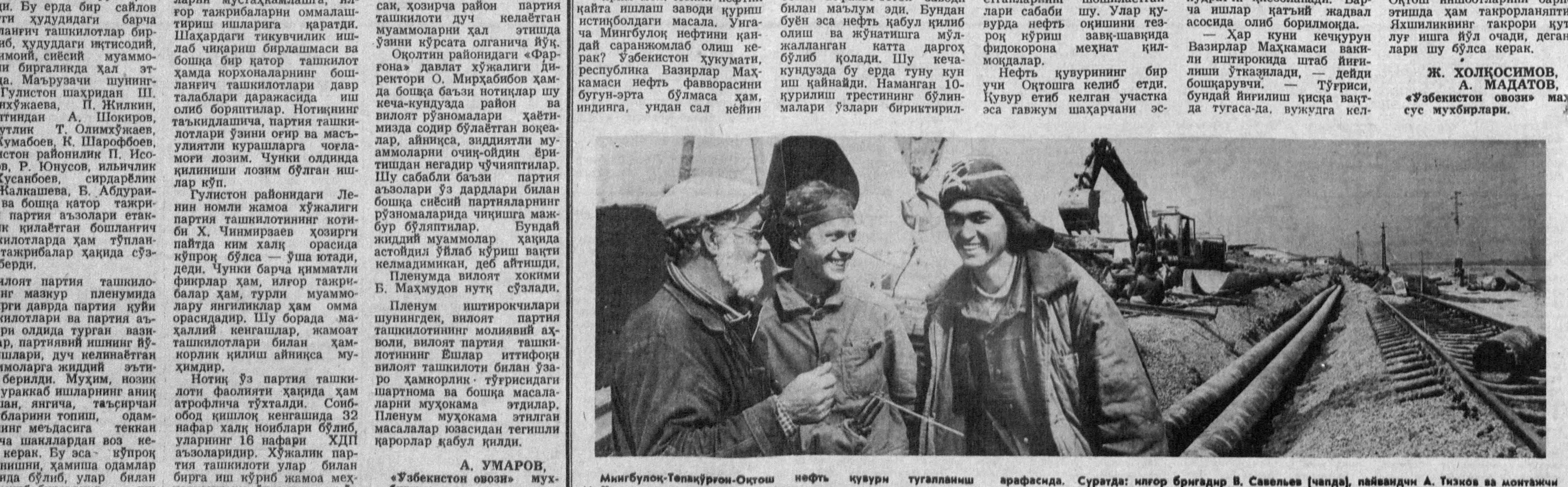
Мингбулоқ-Терақурғон-Оқтош нефть қувури тугаланиши арафасида. Суратда: илгор бригадир В. Савельев (чапда), пайвандин А. Тизков ва монтажчи Суратқаш П. АҚБАРОВ.
