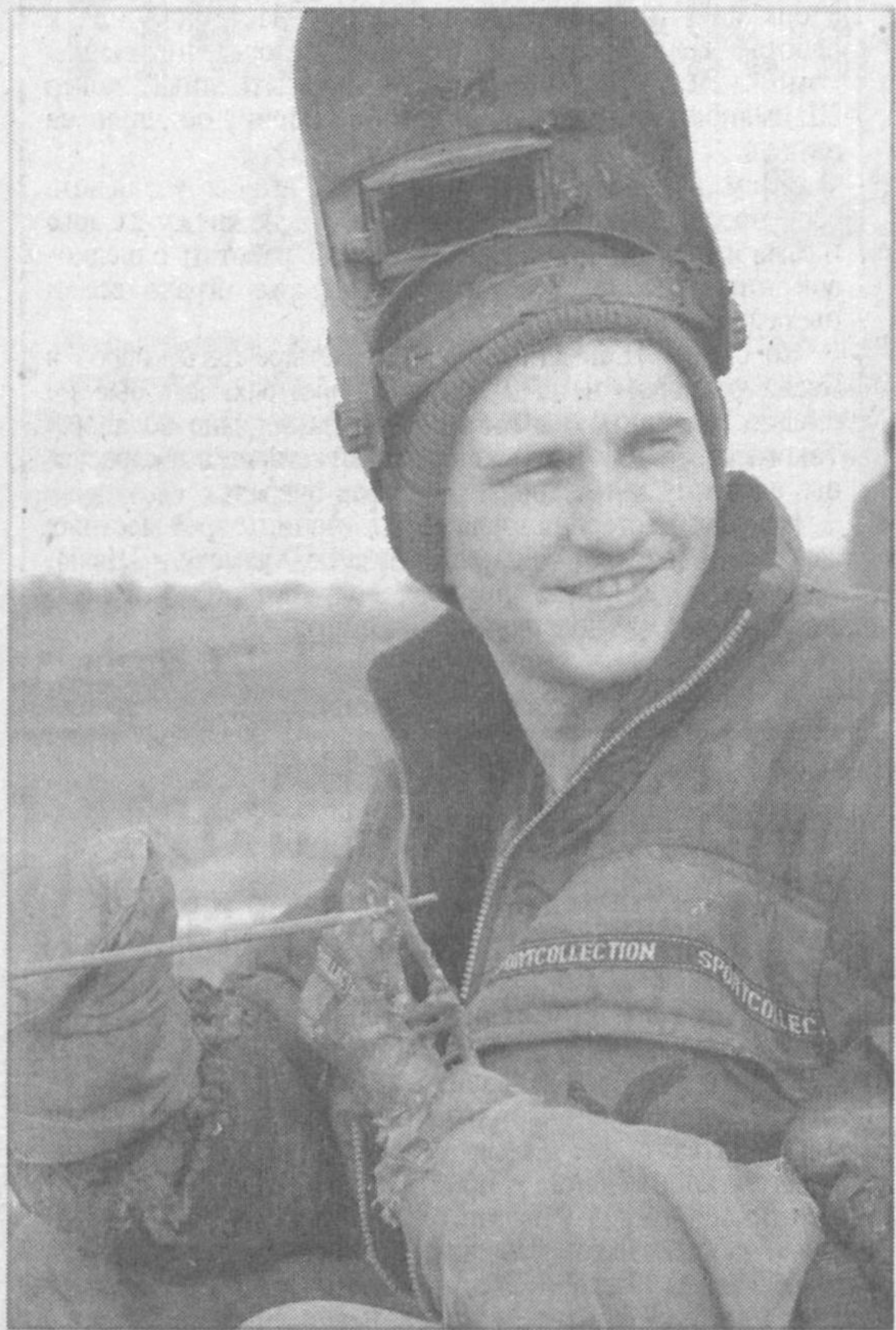
Специалисты ООО "ПМК-2" ускоренными темпами ведут сегодня строительство педагогического профессионального колледжа на 540 ученических мест в селении Шуралисай Янгильского района Ташкентской области.
