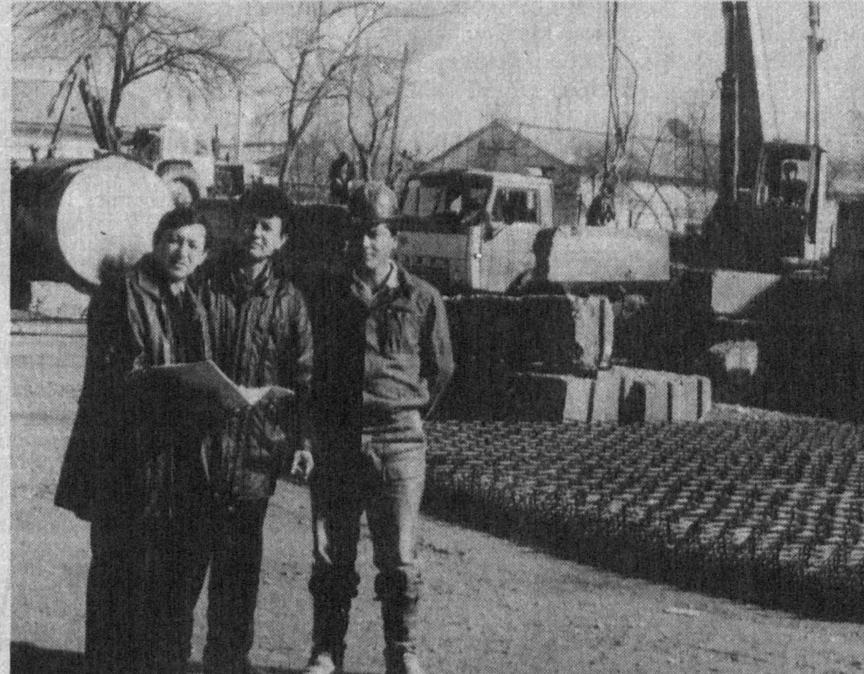
Самарқанд шаҳрида «Дельфин» сузиш ҳавзаси бунёд этилмоқда. Замонавий услубда қурилаётган ушбу муҳташам спорт мажмуи 500 томошабинга мўлжалланган. Унинг қурилишида Ўзбекистон касаба уюшмалари Федерацияси Кенгаши мутахассиси Зоҳид Турсунов ва бунёдкор Улмас Нарзикуловлар навбатдаги ишлар ҳақида суҳбатлашмоқда; автокран бошқарувчиси Зайниддин Ражабов.
