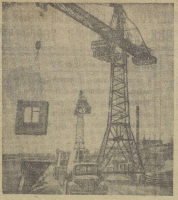
Труженики Самарканда решили построить в Ташкенте пятиэтажный 110-квартирный крупнопанельный жилой дом. Первая группа строителей с оборудованием и техникой уже находится в Ташкенте. Интенсивно ведется отгрузка панелей в столицу республики на местном докостроительном комбинате. Эта работа запечатлена на снимке фото-корреспондента Узбекского телеграфного агентства А. Кузменко.
