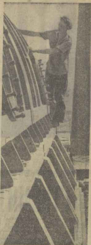
Ташкентская ГРЭС. Коллектив монтажников ведет монтаж пятого турбогенератора, который вступит в эксплуатацию в этом году и даст еще 150 тысяч киловатт электроэнергии.
