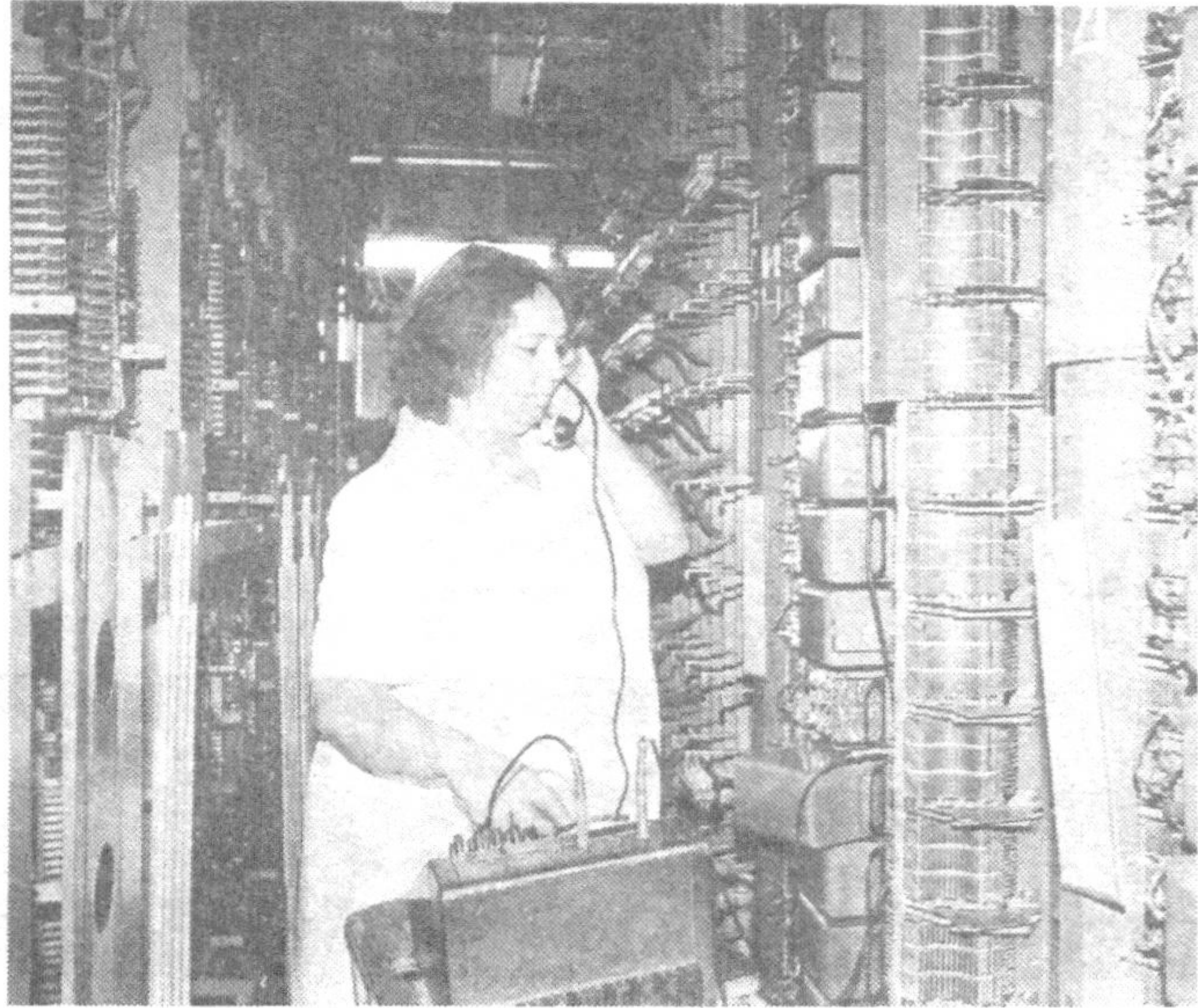
Главное богатство любого предприятия — это люди, их энергия, знания, опыт. А опыта станционному инженеру АТС-62 Нине Викторовне Ляпиной не занимать, здесь она работает 27 лет. Сейчас она возглавляет бригаду, которая обслуживает 10 тысяч телефонных номеров. Несмотря на солидный производственный стаж, она считает, что сегодня все должны учиться. Тем более в скором времени декадно-шаговая система будет переводиться на электронную.
