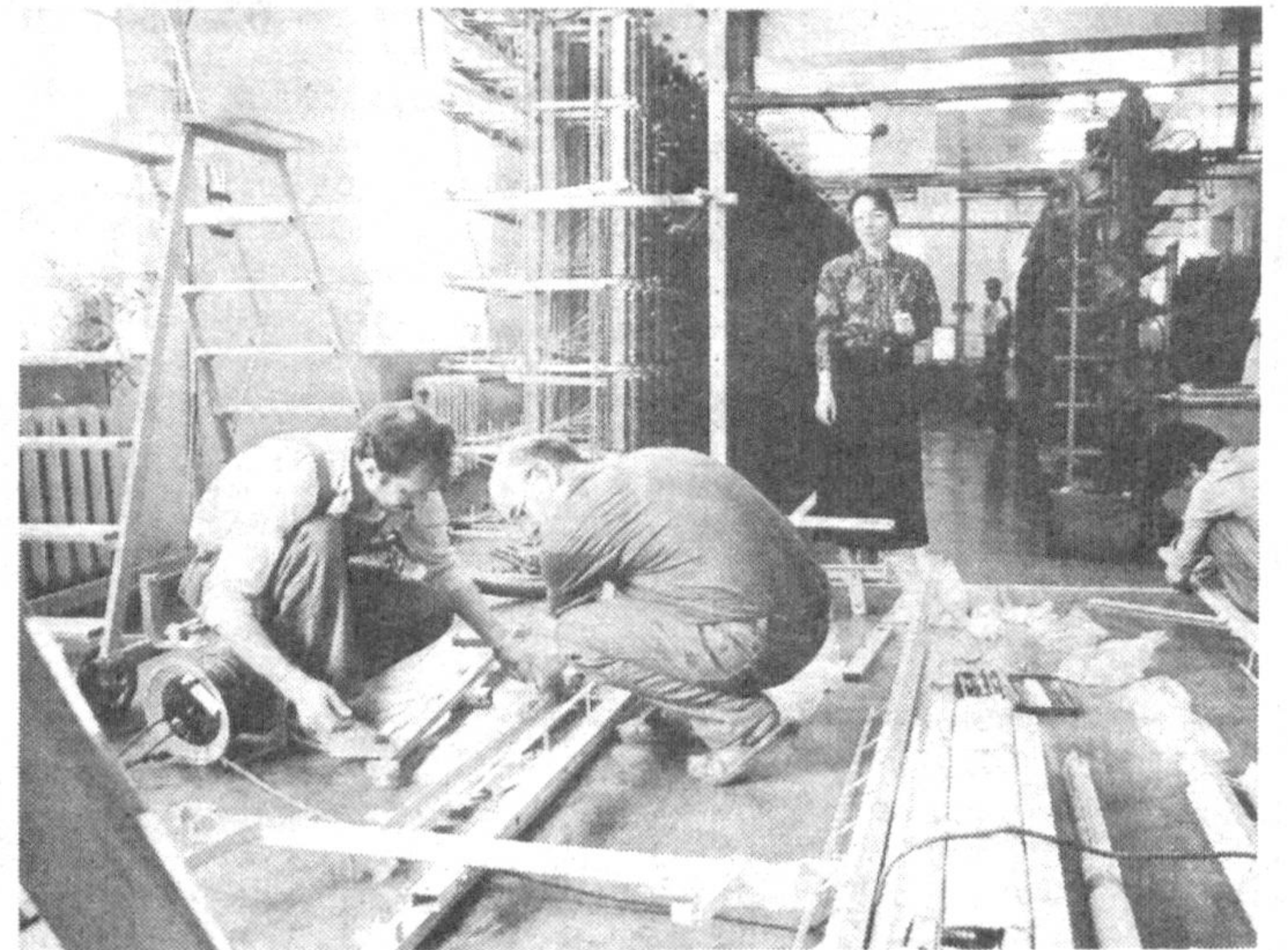
На снимке: специалисты германской фирмы «Сименс» совместно со специалистами МП «Услуги связи» ведут монтаж новой электронной системы.
