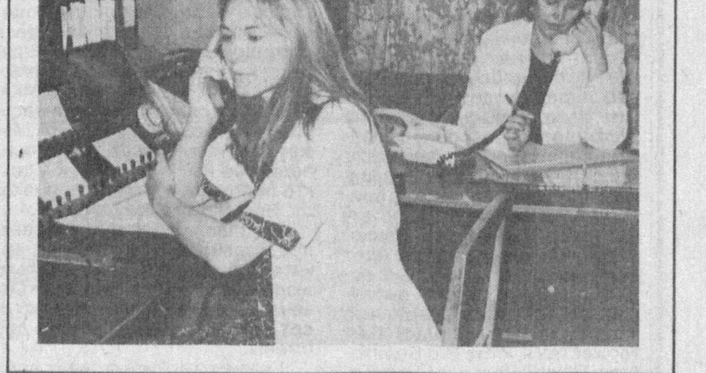
Раилова Шаякубова, Олег Петрович Ковалев и станционный инженер Альмира Хасановна Газизова; (справа) в кроссе станции — электромеханик Светлана Антоновна Нармуратова и Татьяна Антоновна Бабишева держат под контролем каждую неисправность, неполадки до полного их устранения.
