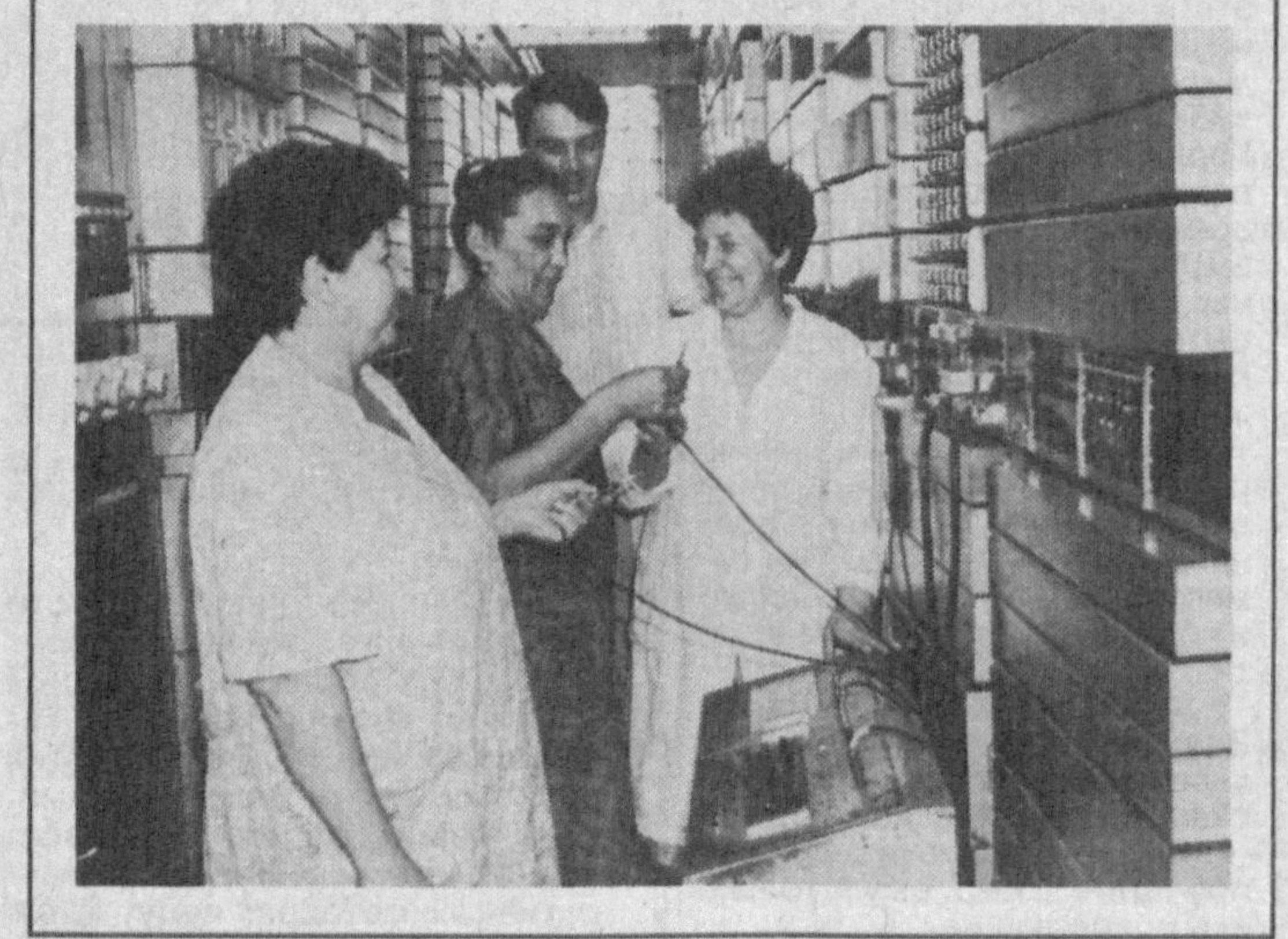
Бесперебойную, четкую работу телефонной сети АТС-29 надежно обеспечивают высококвалифицированные специалисты автомазла и кросса станции. На снимках (слева): в автомазле АТС-29 — регулировщица Нина Александровна Майтатова, электромеханик Гульшара
