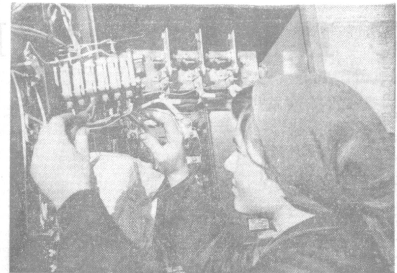
Отличный трудовой подарок Первомаю и съезду ВЛКСМ привнесла электромонтажница андижанского завода «Электроаппарат» комсомолка Миннояр Хамраулова. Работая на сборке панелей щитов управления, она досрочно выполнила личное пятилетнее задание. На снимке: М. Хамраулова за работой. Фото В. СИРОТКИНА.
