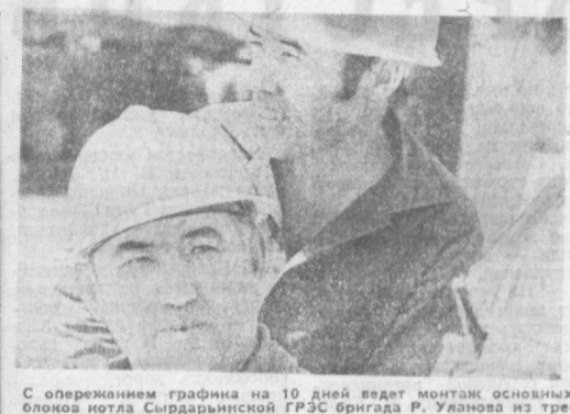
С опережением графика на 10 дней ведет монтаж основных блоков котла Сырдарьинской ГРЭС бригада Р. Уланова из треста «Средазэнергокомонтаж». На снимке (слева направо): Р. Уланов, звеньевой М. Галимов. Фото В. МОЛГАЧЕВА.
