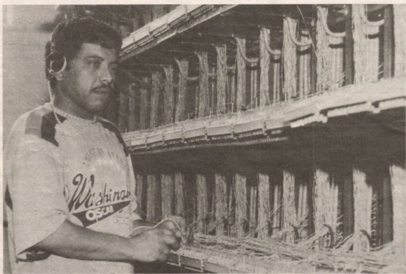
Бухоро вилояти, Ромитан тумани электралоқаси АТСининг катта электромеханиги Саъдулло ТУХТАЕВ кроссда профилактика ишларини олиб бормоқда.
