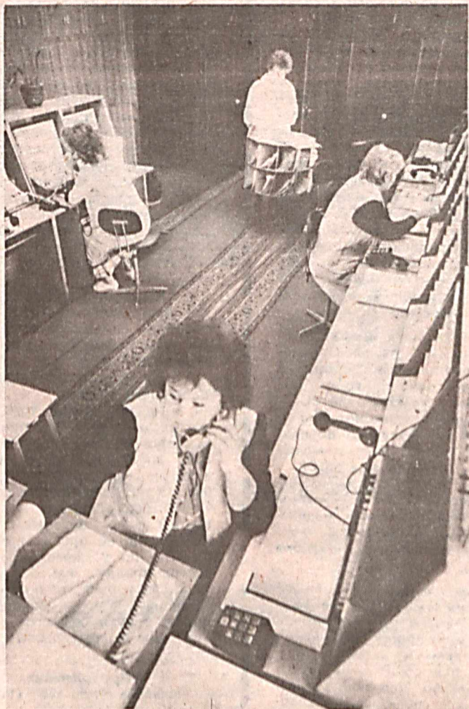
Пульт централизованной охраны Фрунзенского РОВД. На переднем плане: оператор ПЦО Ольга Щербаква. Сюда поступают тревожные сигналы в том случае, если на объекте, взятом под контроль автоматикой отдела охраны что-то случается. К примеру, заявится непрошенный гость.
