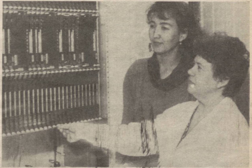
Тошкентдаги 44-АТС рақамли электрон тизимга ўтказилди. Бу пайта «Алкател» фирмаси ҳам фаол иштирок этди. Айни пайтада ушбу станция фойдаланишга тайёр. Собир Раҳимов телефон тармоғининг бош муҳандиси ўринбосари Т. Тухтамова ва 44-АТСнинг электроника муҳандиси Г. Шомбаева станцияда ўрнатилган янги алоқа жиҳозларини ишлашни текширишмоқда.
