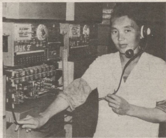
На снимке: Дежурный техник службы полуавтоматики АТС-7 г. Нукуса Зарипа СЫРБАЕВА проверяет техническое состояние оборудования.
