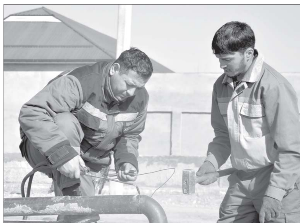
Ходимони филиали таъминоти гази «Худудгаз Сурхондарё» дар ҷамоати шаҳрвандони маҳаллаи Гулистони шаҳри Тирмиз ба мақсади аз гази табиӣ баҳраманд гардондани аҳолии кубурҳои гази насб менамоянд.
