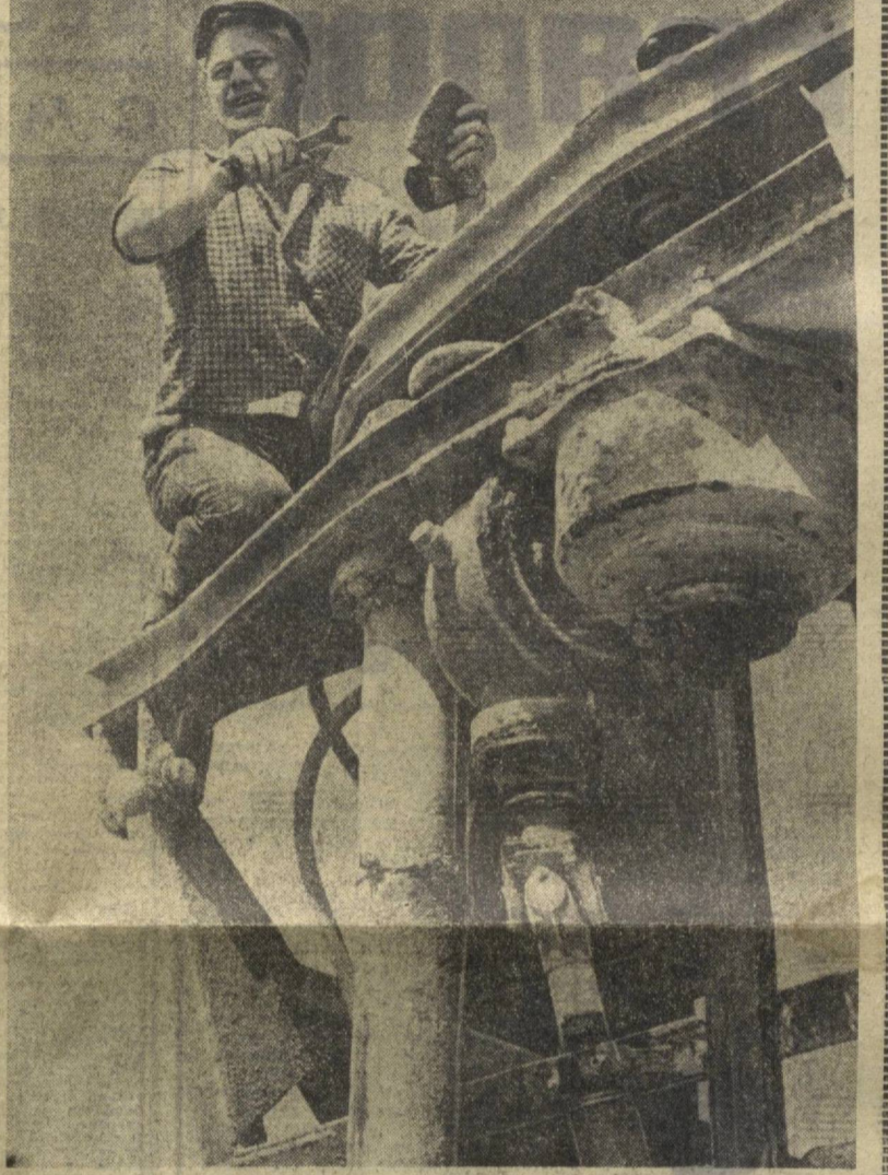
Борис Николаевич Баранов считается лучшим бурлящим снальных пород на строительстве Червского гидроузла. Он работает здесь с 1963 года и пользуется неизменным уважением коллег-строителей. Фото В. СИРОТКИНА и И. ГЛАУБЕРЗОНА.
